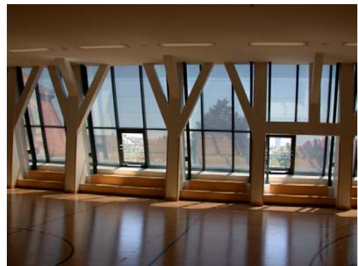
Bild 2: VOLTARLUX ® Solarstromglas in der Sporthalle der Dom Pedro Schule, München
